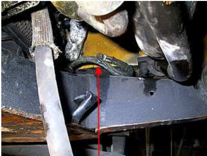
Tresse de masse de la caisse au berceau à débrancher
